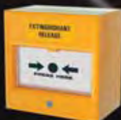
Pulsador de Descarga de Gas (Extinción)
