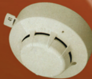
Detector de Humo Fotoeléctrico
